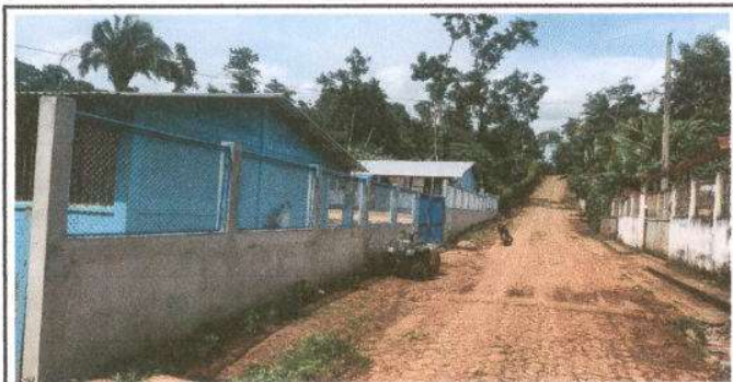
Foto 5: Reparación de muro perimetral de bloc con tubo hg y malla galvanizada, soleras intermedias y columnas
